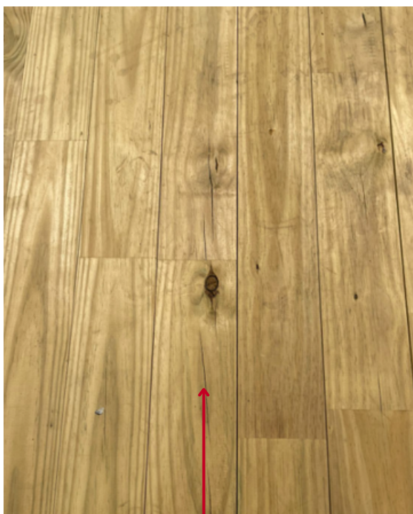
FISSURAS COMUNS NO CLT
