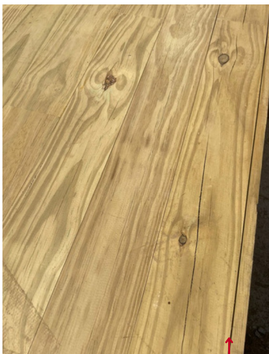
TRINCAS COMUNS NO CLT
